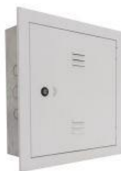
Figura 6: Distribuidor Geral de Telefonia - DGT
